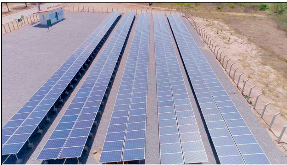
Usina Solar Fotovoltaica da UFERSA. Campus Mossoró, RN.
