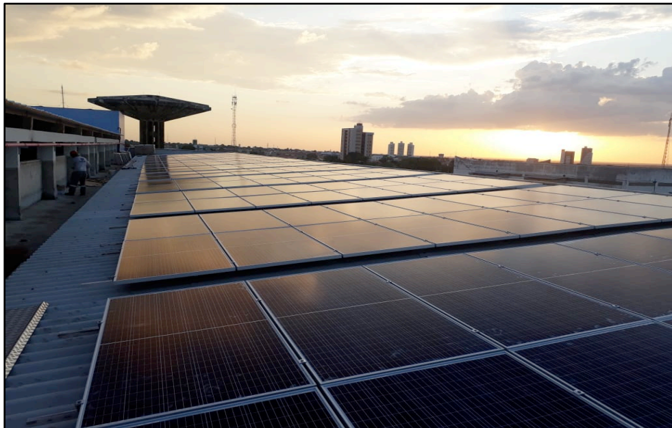
Usina Solar Fotovoltaica da UFERSA. Campus Mossoró, RN.
