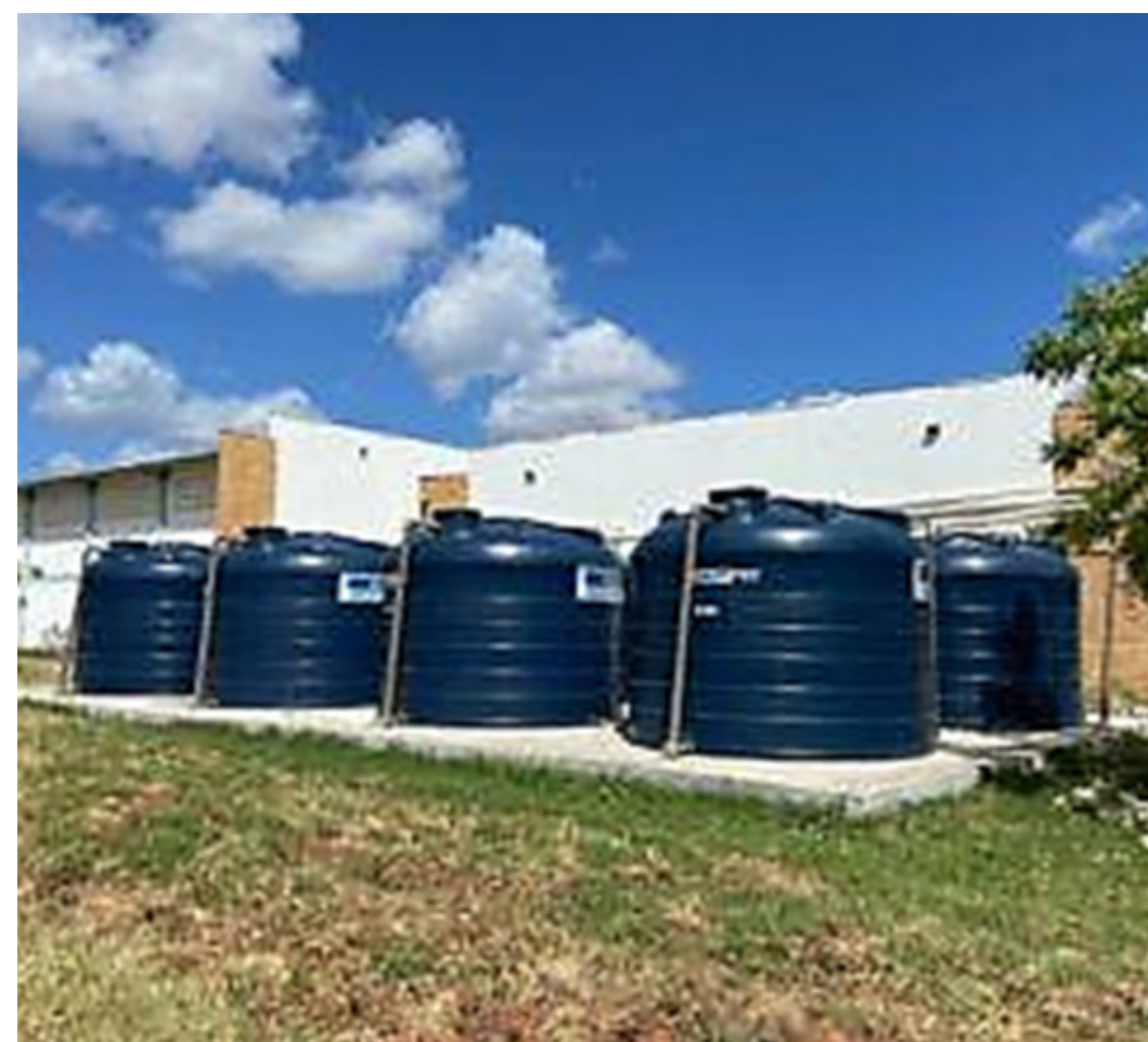
Figura 51 - Sistema de reuso de águas pluviais do complexo de Transportes, Patrimônio e Almojarifado (TPA) do campus Mossoró/RN
