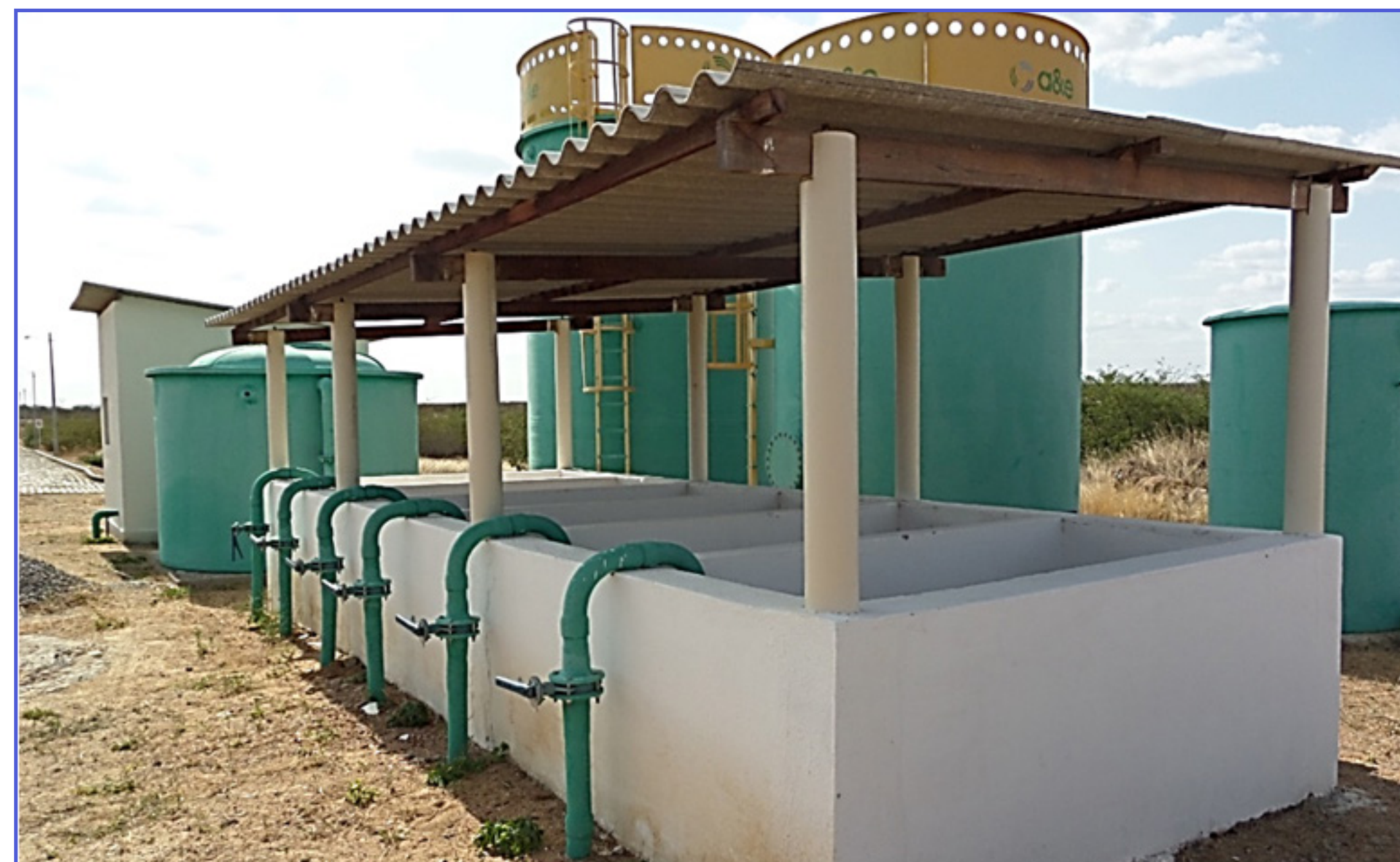
Figura 74 - Estação de tratamento de esgoto do Câmpus Caraúbas
